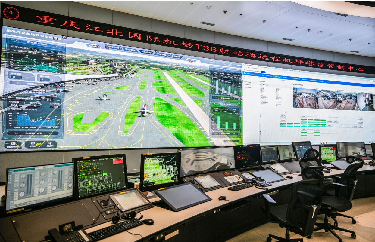
重庆江北机场 T3B 航站楼远程机坪塔台管制中心
