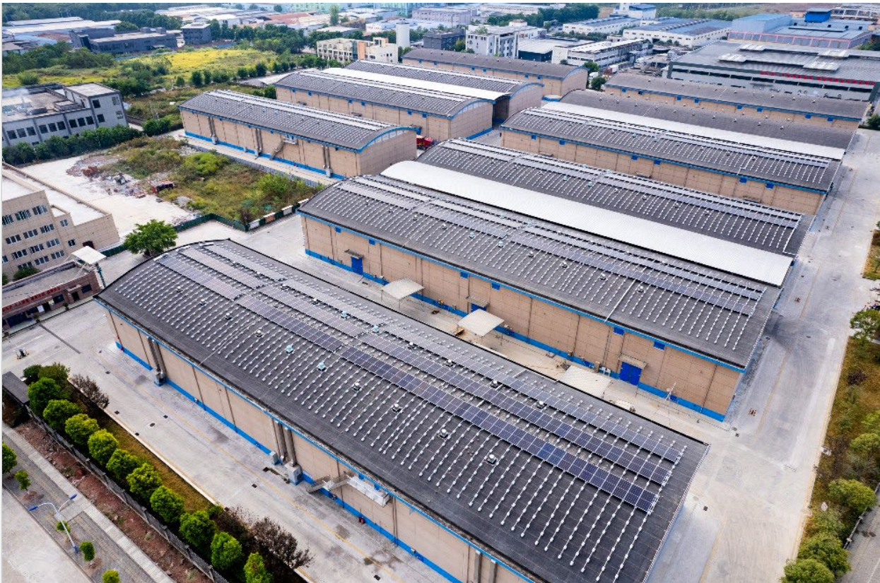
重庆储备粮集团长寿储备库仓顶光伏项目
